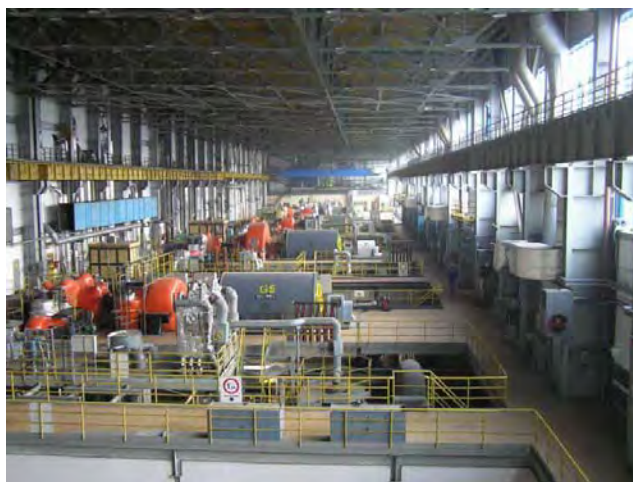
Hala maszynowni w Elektrociepłowni Gdańskiej
