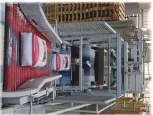
fragment linii technologicznej
