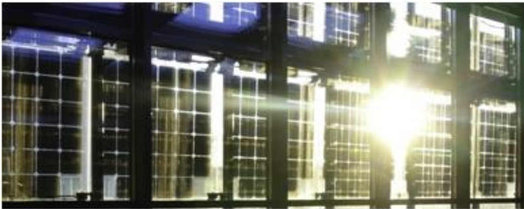
Instalacja fotowoltaiczna na południowej fasadzie kaskadowej widoczna z wnętrza budynku
