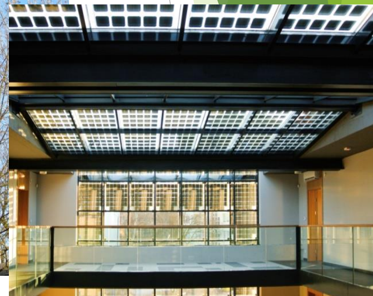
Instalacja fotowoltaiczna widoczna z wnętrza budynku
