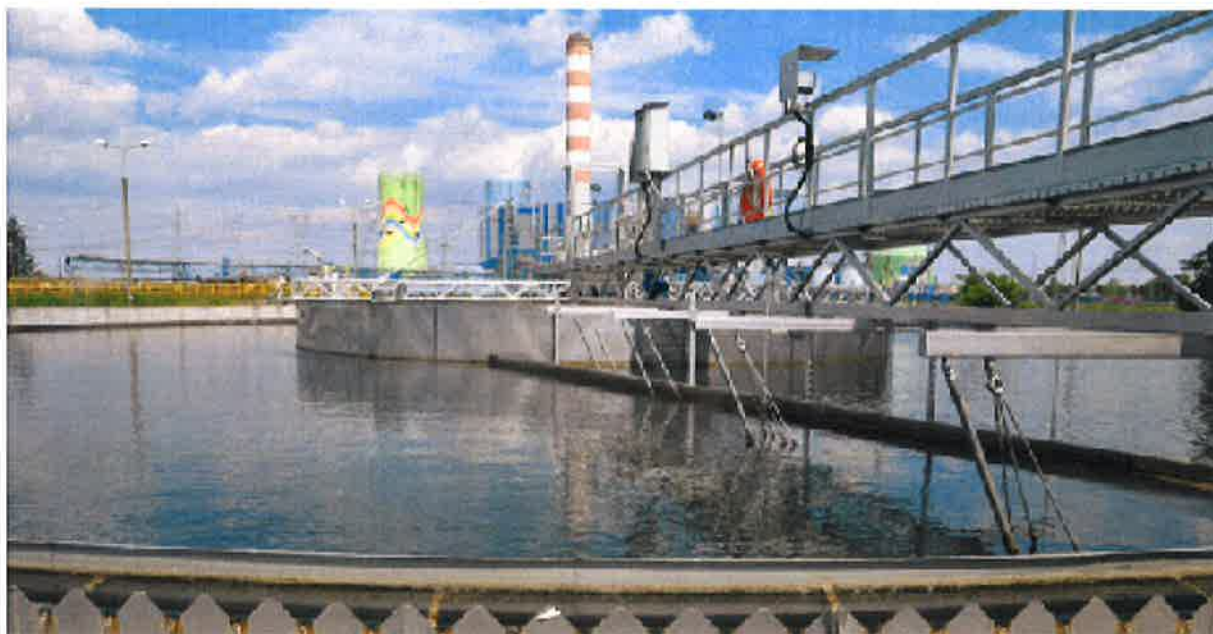
Fot. nr 6. Końcowa oczyszczalnia ścieków
